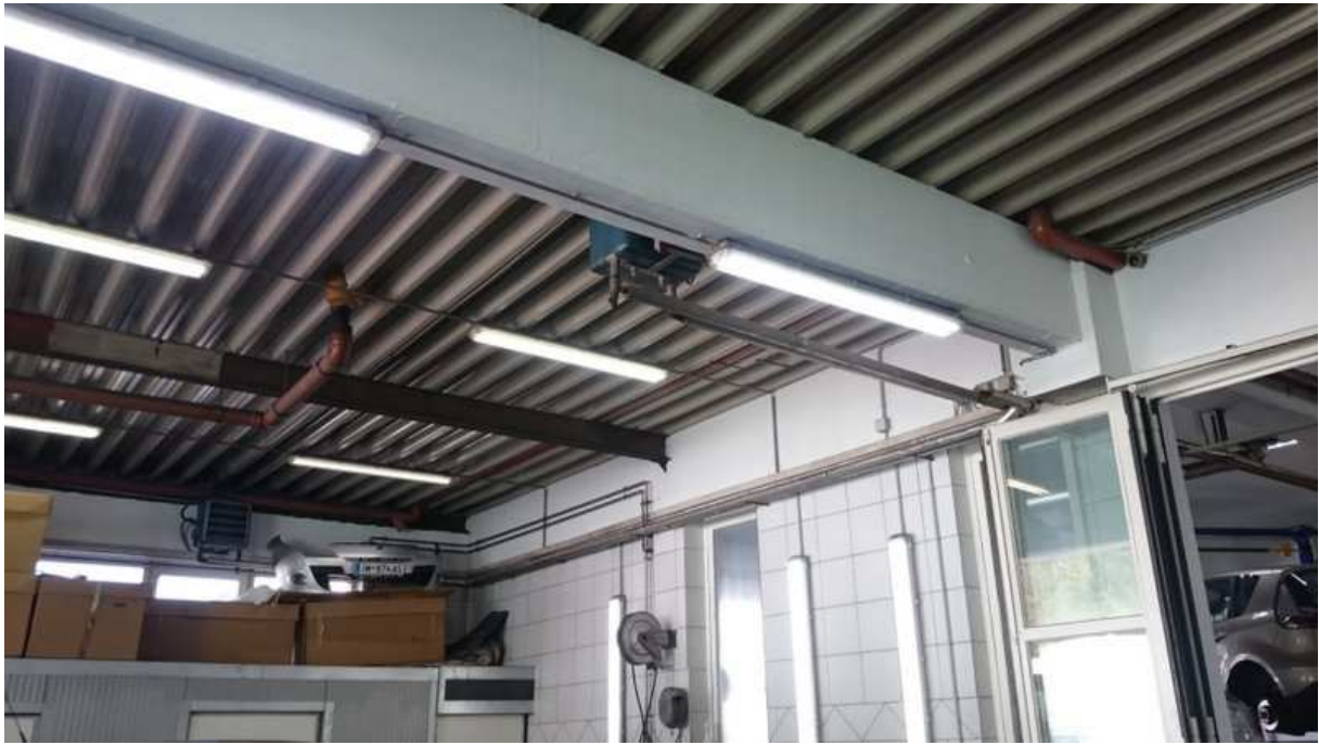
Werkstatt Bestand – Metaldeck wird ersetzt
